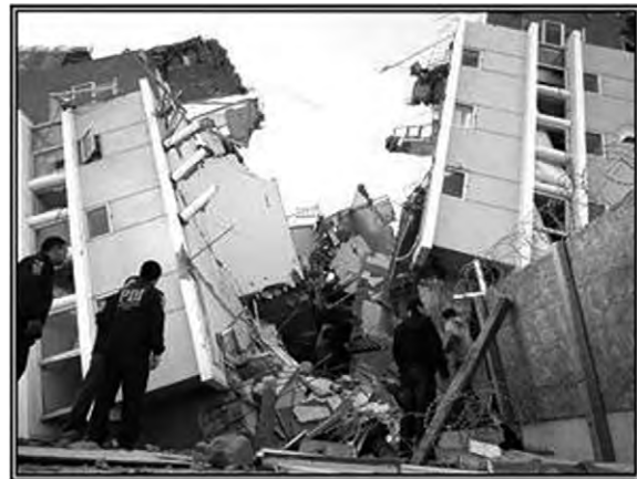
Figura 1. Falla en edificio de apartamentos, Terremoto de Chile febrero del 2010 (Arqchile.cl, 2001ISSN 0718-431Xversión en línea) [1]
