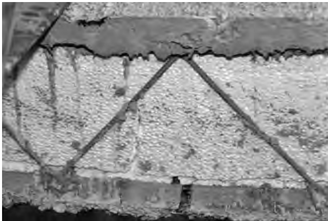
Figura 8. Fractura del acero longitudinal y separación de la lámina calibre 20 correspondiente al nervio
