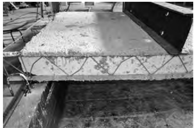
Figura 6. Pandeo de las diagonales o celosías de las losas LT1 y LT4
